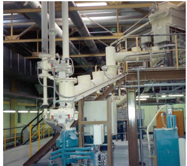
Luftförderrohre in der Kernmacherei bei BMW. D - Landshut.
